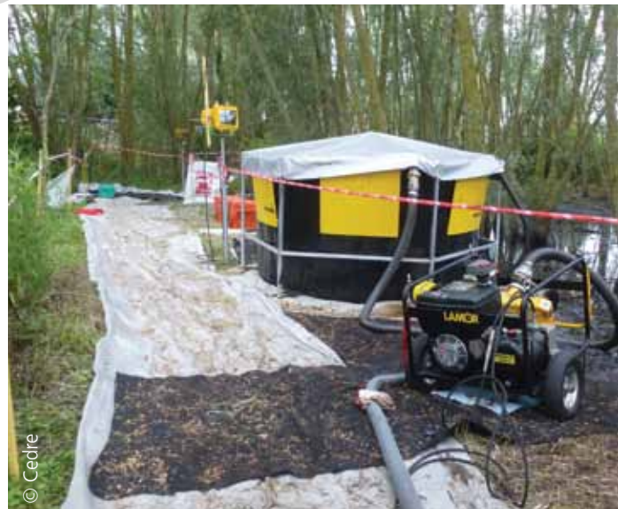
Pompe de transfert associée et capacité de stockage-décantation
