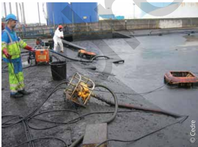
Récupérateurs à pompes associées
