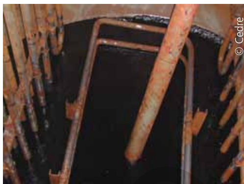
Cuve d'un navire dotée de serpentins de réchauffage
