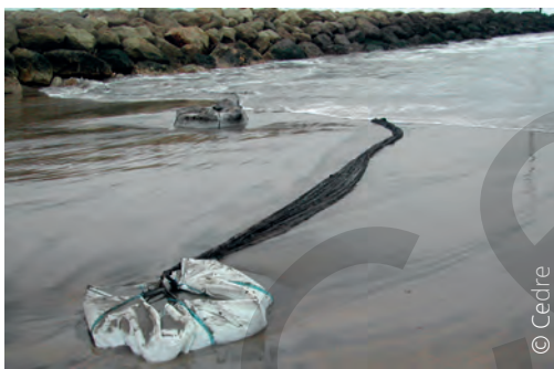
Captage par filet serpillaire
