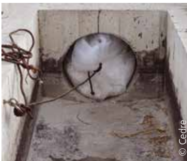
Cartouche filtrante constituée de fibres hydrophobes à l'entrée d'une canalisation
