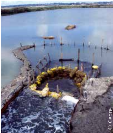
Dispositif expérimental de filtration à base de coquilles d'huîtres, paille et pouzzolane à l'entrée d'une vasière
