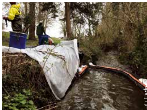
Géotextiles pour protéger les berges, barrages absorbants pour confiner et récupérer le polluant
