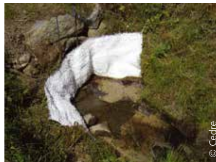
Barrière filtrante en fibres hydrophobes à l'entrée d'un émissaire
